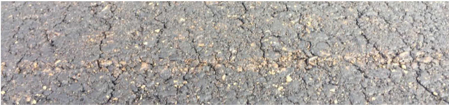
Pemadatan semasa asphalt telah sejuk menyebabkan keretakan halus pada permukaan turapan.
